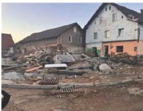
Fot. 13. Uszkodzenia budynków spowodowane powodzią w 2024 roku - archiwum PIIB
