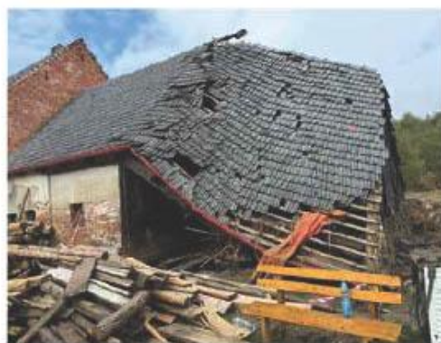
Fot. 14. Uszkodzenia budynków spowodowane powodzią w 2024 roku - archiwum PIIB
