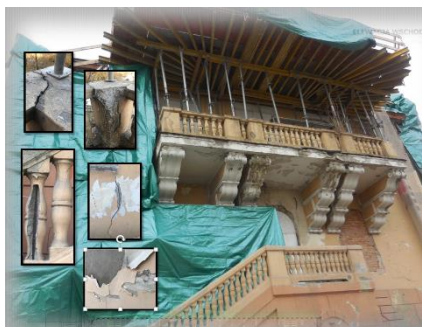
Fot. 2.15.1. Elewacja wschodnia – stan degradacji
