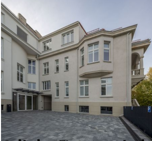
Koniec remontu siedziby PIR przy ul. Krzywokiej 1 w Warszawie. Budynki w trakcie modernizacji
