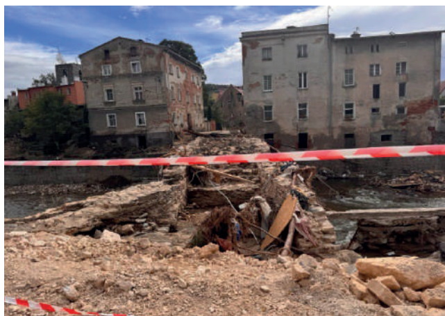
Fot. 14. Uszkodzenia budynków spowodowane powodzią w 2024 roku – archiwum PIIB
